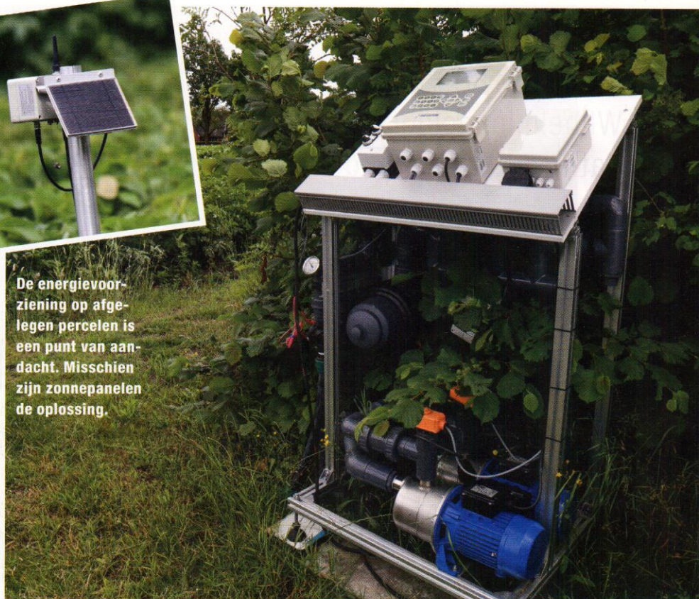
Opstelling van de pompen en regelkast bij het perceel. Grondwater kan niet direct gebruikt worden omdat het te veel ijzer bevat en daarom risico op verstopte druppelslangen geeft.
